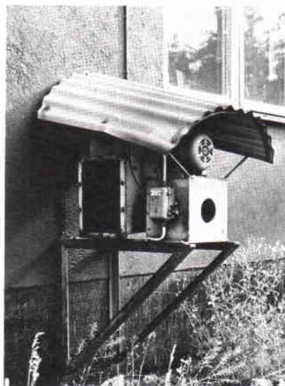
Gnistfri utsugsfläkt på verkstadsväggens utsida.
